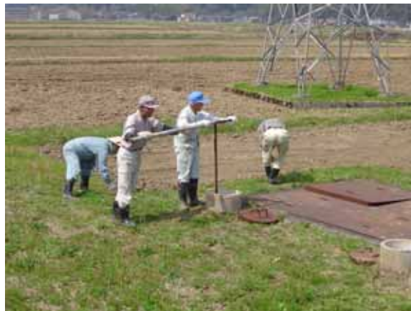
計画に基づいた配水操作の実施
