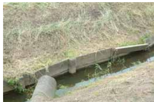
水路側壁のはらみの状況
