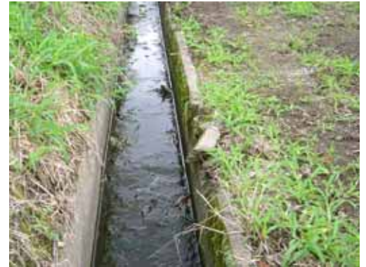
破損したU字溝
