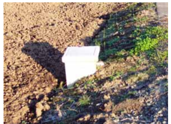
傾いた給水栓ボックス
