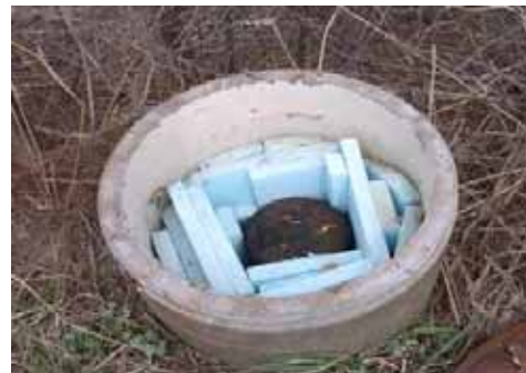
給水栓ボックス内の保温状況
