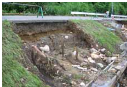
道路法面の崩壊状況
