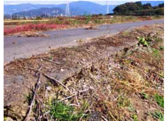
路肩の浸食と路面下の空洞
