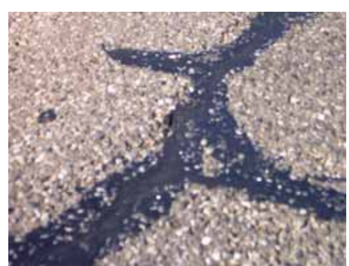
ひび割れの補修（路面） （アスファルト乳剤系補修材による補修）
