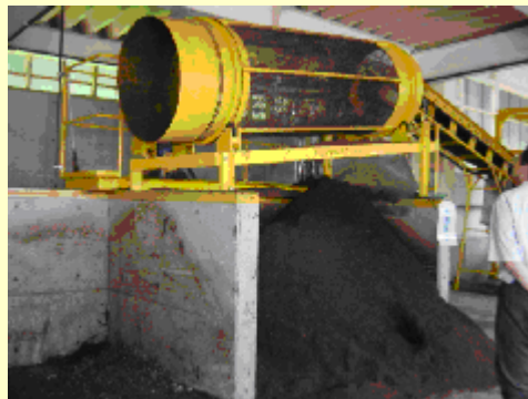
堆肥プラント
