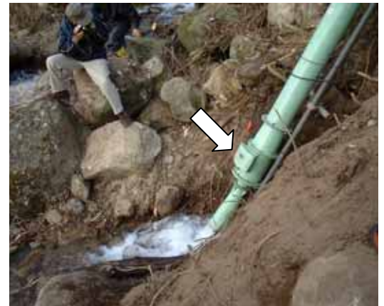
簡易な発電機(図の矢印)
