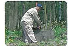
●ゲートの保守管理
