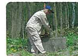
●ゲートの保守管理
