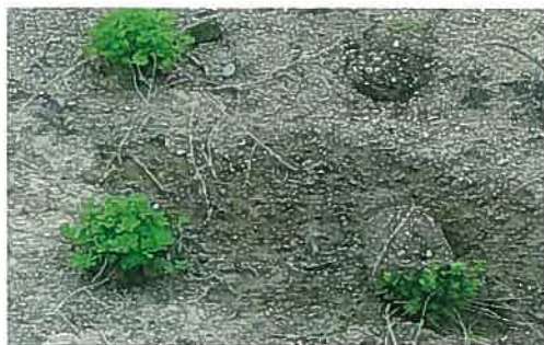
図9.苗の脱落(法面融雪時)
