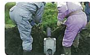
●東川町: 水位調整可能な落口
